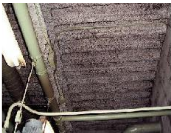
石綿含有吹付けロックウール
