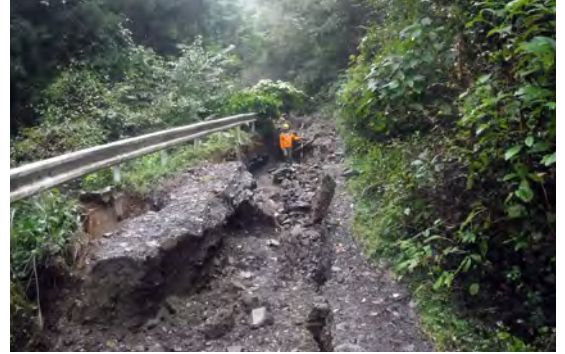
▶寸庭線林道・路面洗堀 (起点から1km) (中央オレンジ色は町職員)
