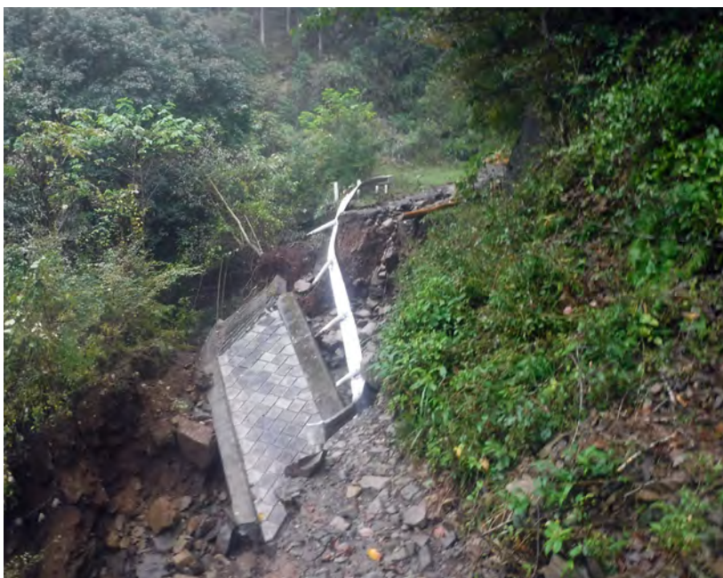
▲寸庭線林道・路側構造物崩壊（起点から1.7km） （白く見えるのはガードレール）
