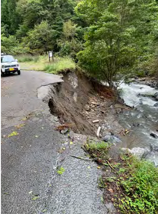
▶大丹波線林道・路側崩落 (起点から100m)
