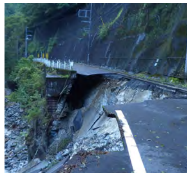
▶崩落した日原街道と仮設歩道
