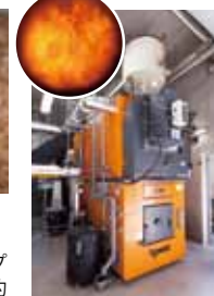
木質チップボイラー
