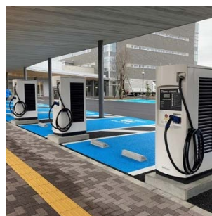
電気自動車用充電スポットの設置 参考（新潟県柏崎市）
