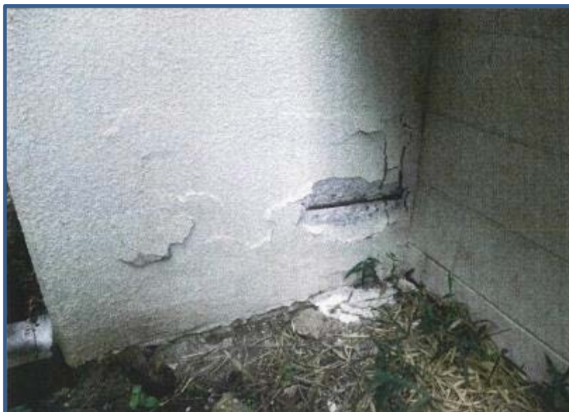
劣化状況（コンクリート爆裂、鉄筋露出によりコンクリートの中性化が進んでいる。）
