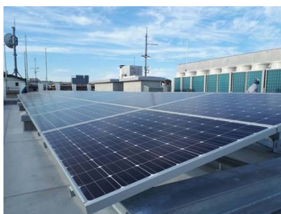
太陽光パネルの設置 参考（東京都瑞穂町）
