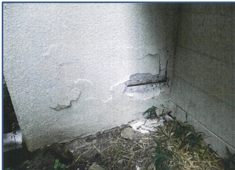
劣化状況（コンクリート爆裂、鉄筋露出によりコンクリートの中酸化が進んでいる。）
