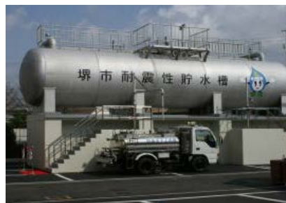
飲料水兼用耐震性貯水槽 参考（大阪府堺市）
