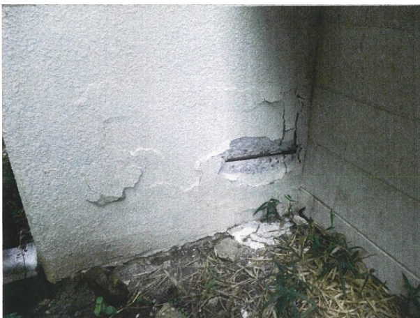
劣化状況（コンクリート爆裂、鉄筋露出）
