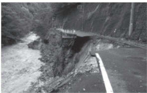
日原街道崩落現場
