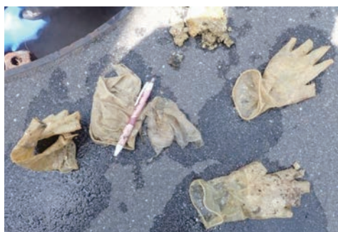
▲ポンプに詰まった異物
